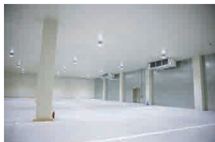
■ F級倉庫(下吹きダクト方式)
